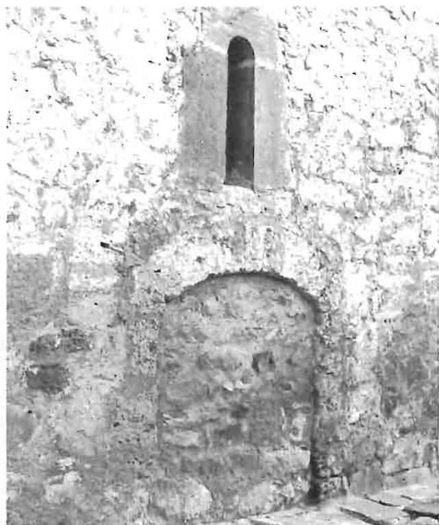
Lám. 38. Vano tapiado. Fachada oeste.
