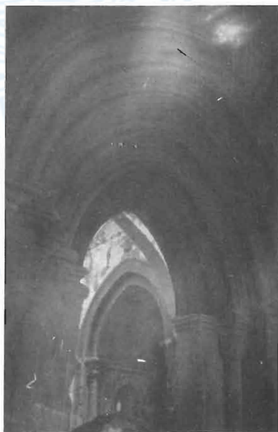
Iglesia de la Villa de Cartes. (Después del incendio del 18 de abril de 1936). Vista de la capilla mayor, a través de la puerta principal.
